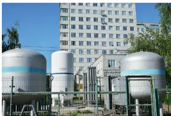
Кислородная станция, установленная в кратчайшие сроки для нужд КОВИД-госпиталя
